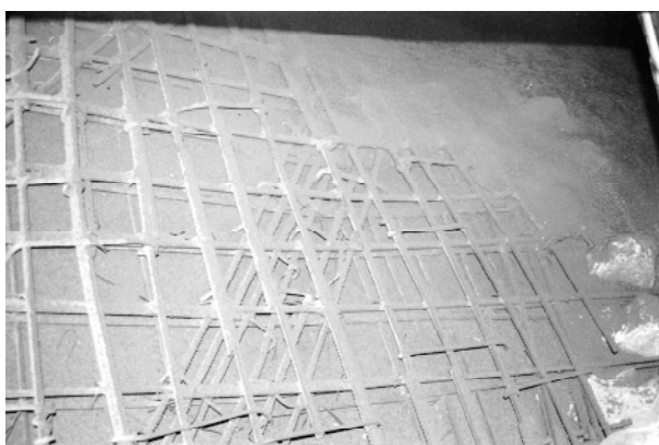
Fot. 31. Fragment zatorkretowania zbrojenia. Widoczne zbrojenie żebra ukrytego
