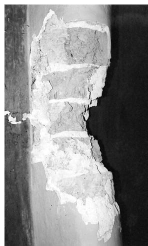
Fot. 35. Zasięg uszkodzenia żebra z fot. 34
