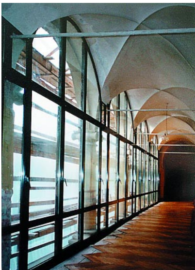
Ściana osłonowa galerii. Widok od wewnątrz w trakcie montażu. Fot. W. Klag
