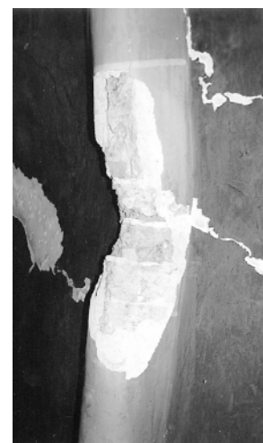
Fot. 36. Zasięg uszkodzenia żebra
