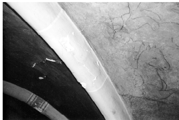
Fot. 34. Widok zewnętrzny uszkodzonej strefy żebra
