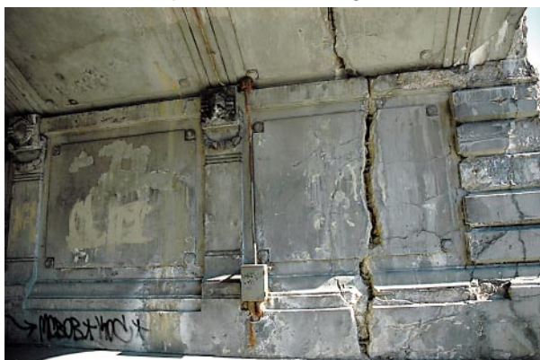
Fot. 8. Pęknięcia sklepienia i ściany przyczółka wsch.
