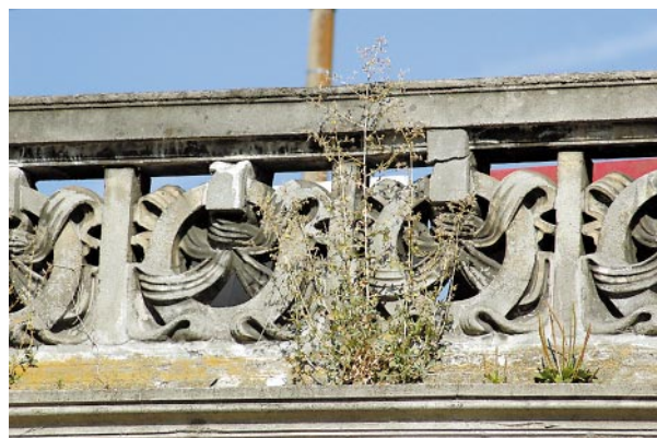
Fot. 11. Typowe uszkodzenia płyt ażurowych balustrady
