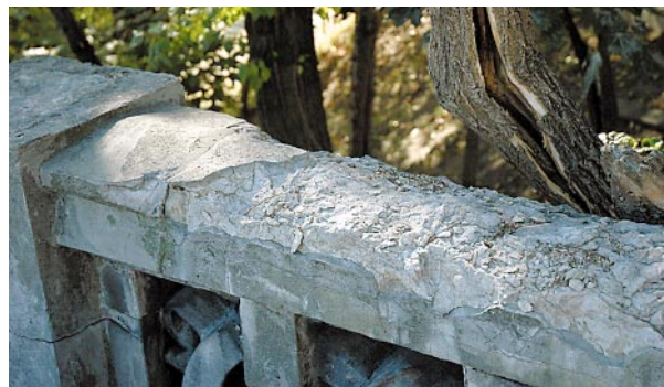
Fot. 10. Degradacja betonowych elementów balustrady
