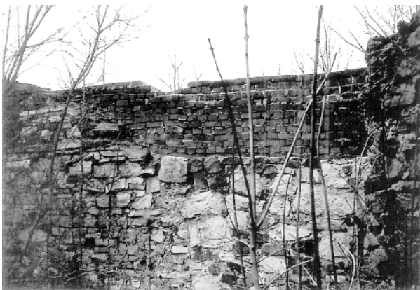
Fot. 2. Przykład „konserwacji” istniejącego muru obwodowego zamku (fot. autora)
