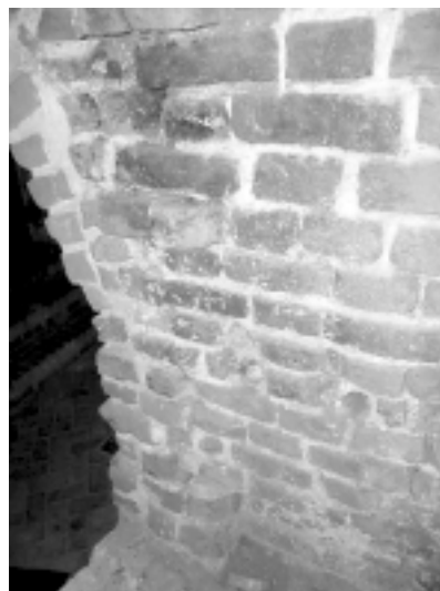
Ryc. 15. Okopczenia widoczne na powierzchni licowej zachodniej ściany komory wewnętrznej pieca. Fot. A.Bojęś-Białasik, 2009 Fig. 15. Soot black visible on the face of the west wall of the internal stove chamber. Photo by A. Bojęś-Białasik, 2009
