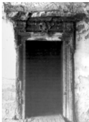
Ryc. 6. Portal w komnacie II piętra przed konserwacją Fig. 6. Portal in a second floor chamber before conservation
