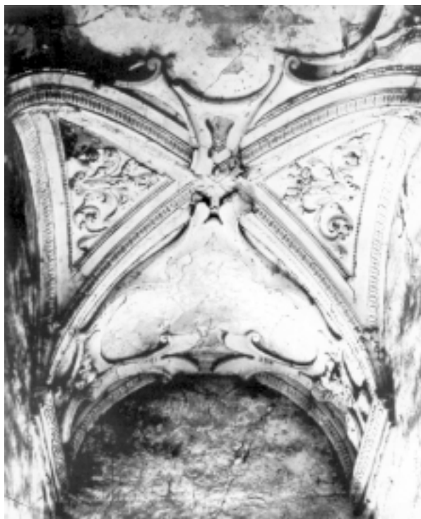
Ryc. 10. Sztukateria Falconiego w chórze kaplicy przed konserwacją Fig. 10. Falconi's stucco in the chapel choir before conservation
