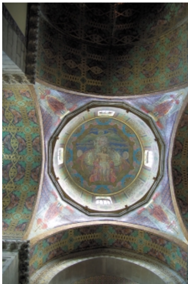
Ryc. 2. Widok na kopułę z wnętrza katedry Fig. 2. View of the dome from inside the cathedral
