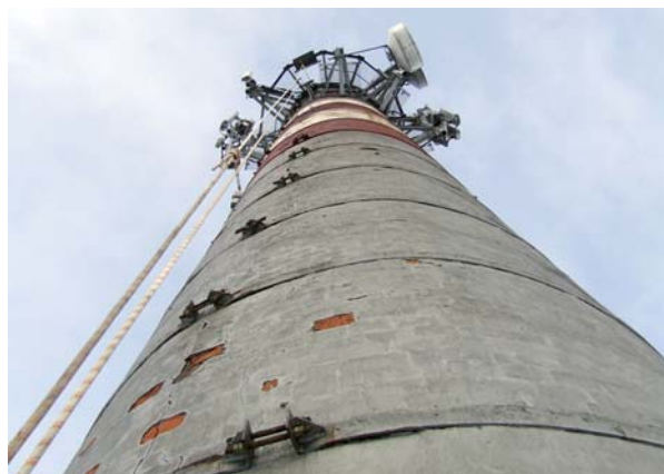
Ryc. 4. Uszkodzenia cegieł i pęknięcia płaszczka Fig. 4. Damage to the bricks and cracks of the chimney jacket
