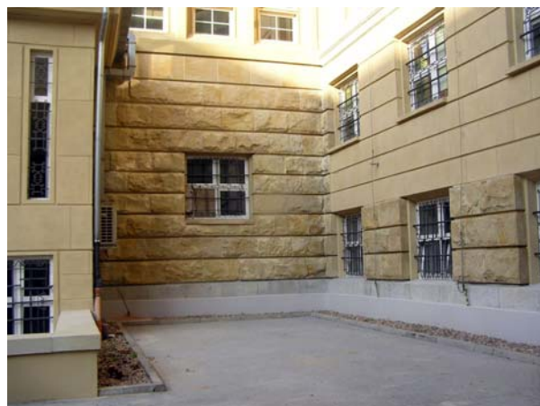
Ryc. 13. Boniowanie elewacji w narożniku północno-wschodnim dziedzińca budynku D1 – przykład oszczędności materiałowych wprowadzonych w trakcie realizacji obiektu. Fot. J. Piskozub, 2014 r.
