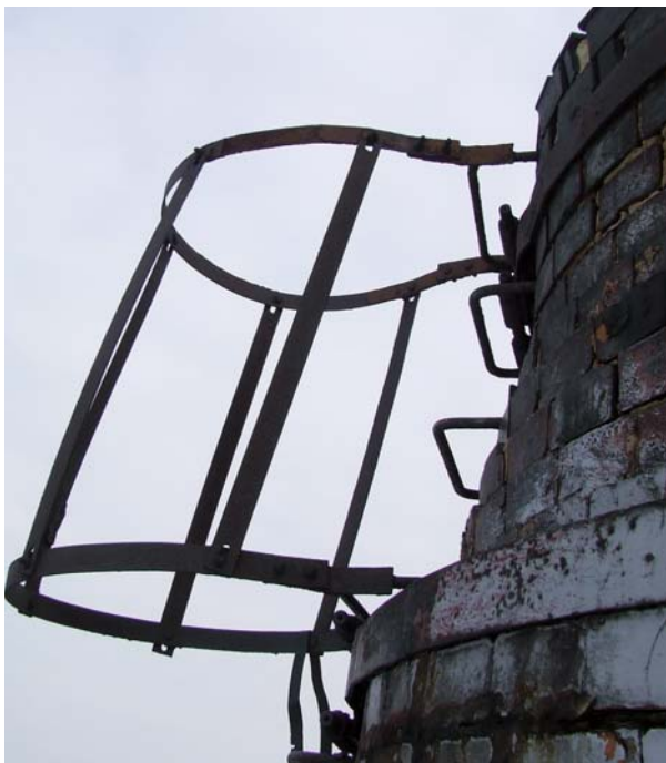
Ryc. 7, 8. Korozja klamer wyłazowych i płaszcza komina Fig. 7, 8. Corrosion of step irons and chimney jacket
