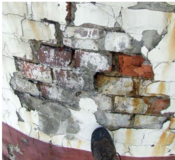
Ryc. 3. Korozja siarczanowa i mrozowa tynku oraz cegieł kominia Fig. 3. Sulfate and frost corrosion of the plaster and chimney bricks
