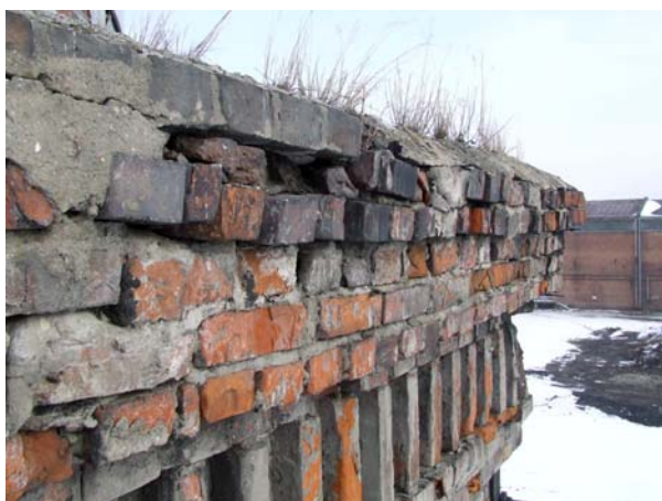
Ryc. 2. Zniszczenia cokołu – ubytki cegieł i spoiny, nawarstwienia, korozja biologiczna Fig. 2. The destruction of the chimney socle – bricks and joints defects, build-ups, biological corrosion
