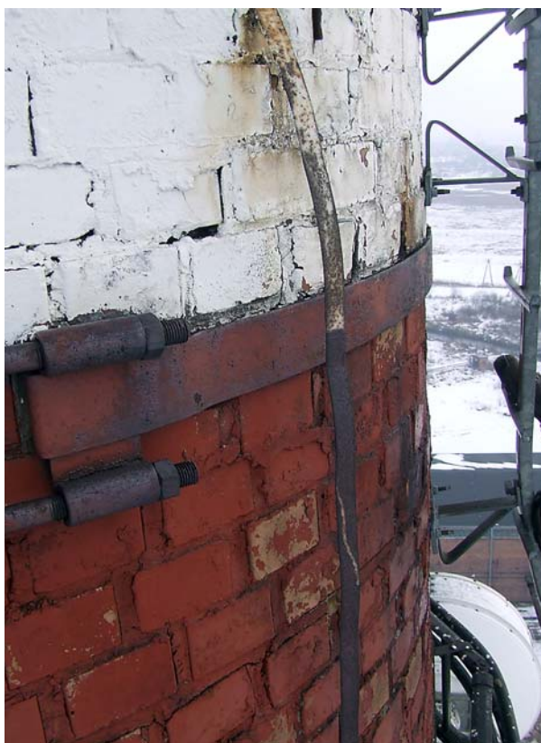
Ryc. 13, 14. Korozja bednarek oraz cegieł i zaprawy komina Fig. 13, 14. Corrosion of chimney band-irons, bricks and mortar
