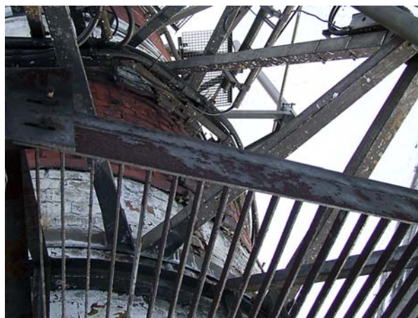
Ryc. 12. Korozja stalowej galerii
