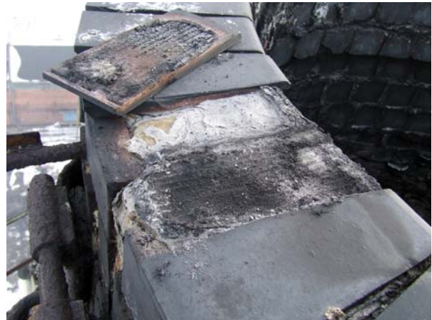
Ryc. 9, 10. Korozja płaszcza przy wylocie komina, odspojenia płytek klinkierowych Fig. 9, 10. Corrosion of chimney jacket at the chimney outlet, detachments of clinker tiles
