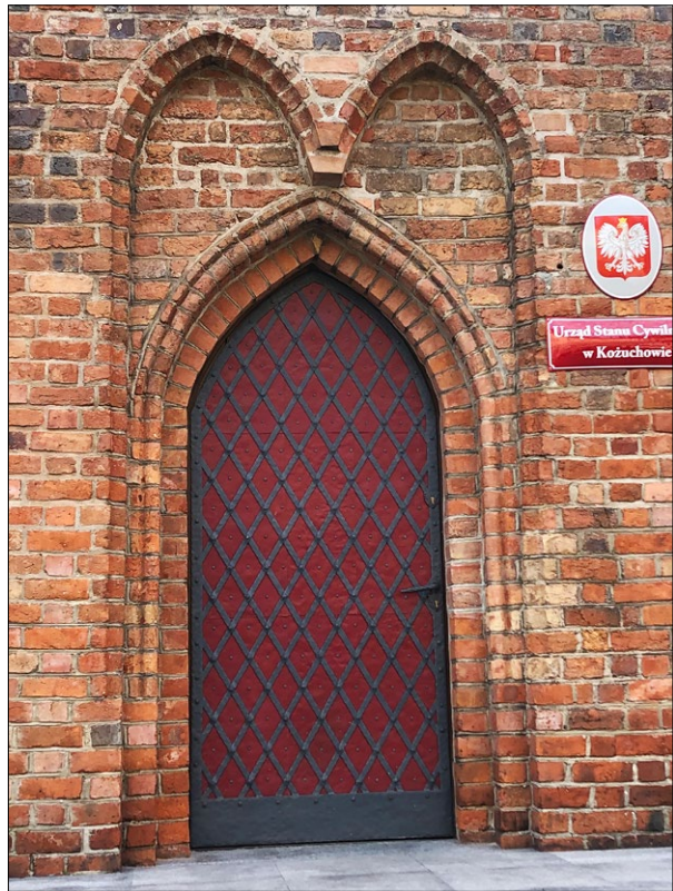
Ryc. 5b. Ratusz w Koźuchowie, elewacja północna, parter, portal, rok 2017; fot. A. Legendziewicz.
