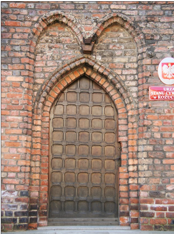
Ryc. 5a. Ratusz w Koźuchowie, elewacja północna, parter, portal, rok 2015; fot. A. Legendziewicz.
