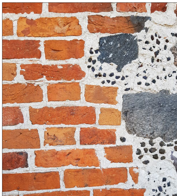
Ryc. 9. Fragment elewacji nawy; widoczne uzupełnienie ściany kamiennej okrzeskami, spoina pomiędzy warstwami cegieł opracowana poprzez dwustronne podcięcie w poziomie i kreskę w pionie; fot. M. Prarat 2019.
