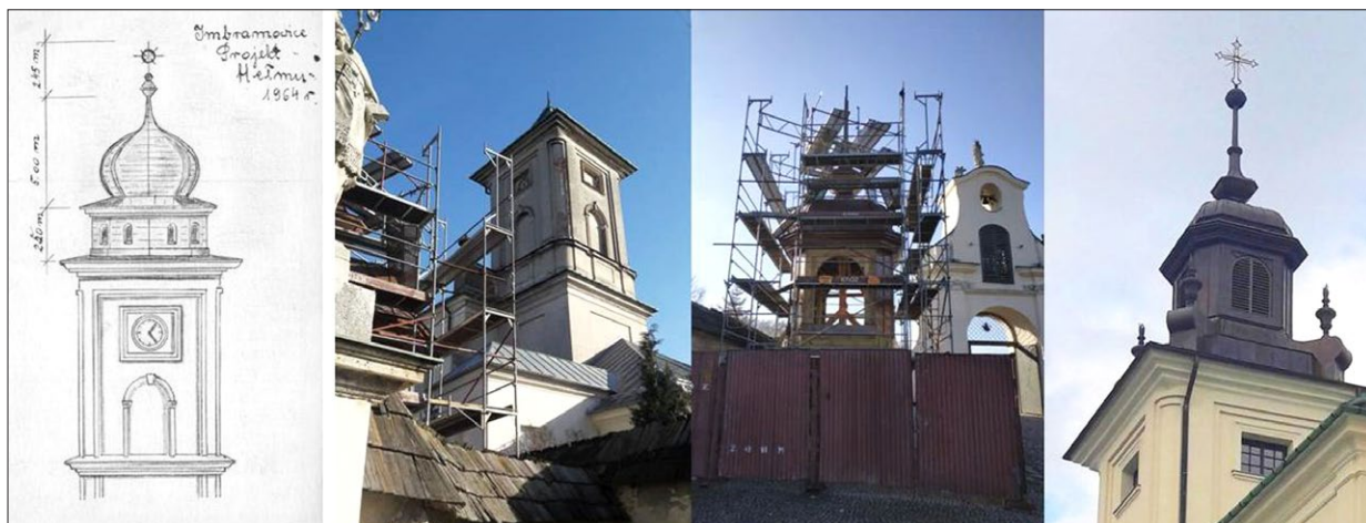
Ryc. 6. Po lewej: projekt helmu na wieży kościelnej z 1964; źródło: Archiwum klasztoru norbertanek w Imbramowicach; w środku: wieża kościelna przed remontem; po prawej: efekty prac przy odbudowie pierwotnego helmu, przed zamontowaniem go na wieży, luty 2019; fot. J. Gil-Mastalerczyk.
