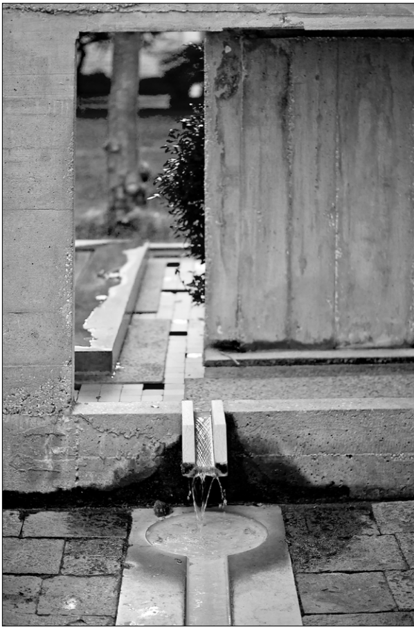
Fig. 1. Detail of the broken concrete wall, Querini Stampalia Foundation, 2014; photo by M. Twardowski. Ryc. 1. Detal przełamanej ściany betonowej, Fundacja Querini Stampalia, 2014; fot. M. Twardowski.
