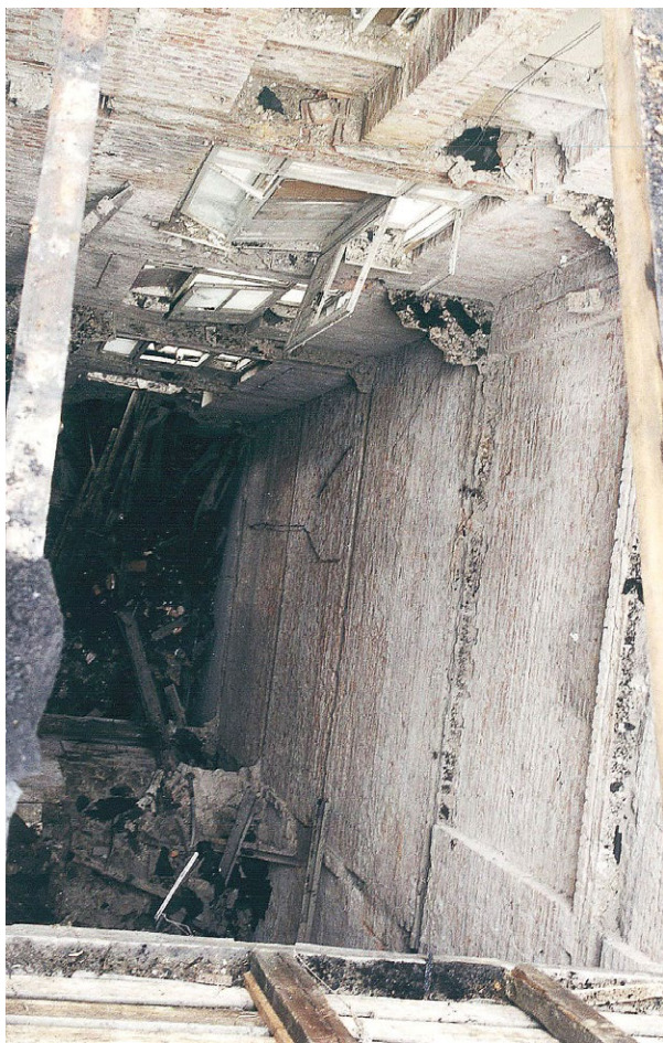
Ryc. 3. Fragment zachodni budynku objęty katastrofą budowlaną; fot. P. Przybysz.
