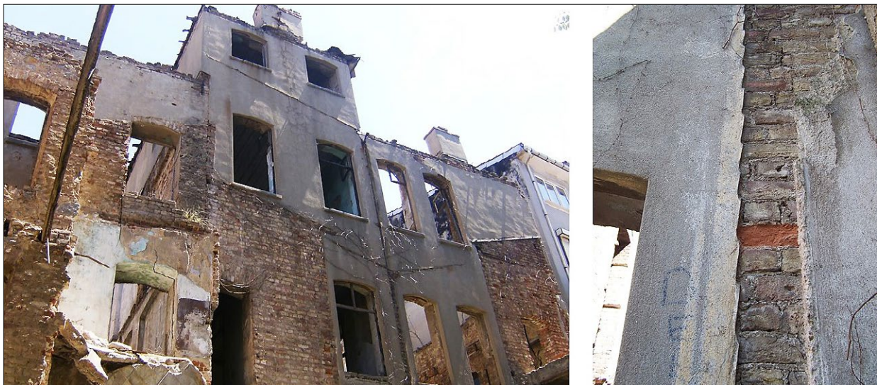
Fig. 7. Traces of the wooden structures at the rear facade of the main building; photo by H.A. Doğan Ryc. 7. Ślady obiektów drewnianych przy tylnej elewacji budynku głównego; fot. H.A. Doğan
